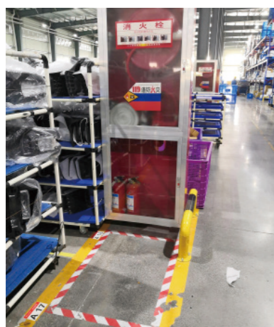
消防设施前无遮挡
